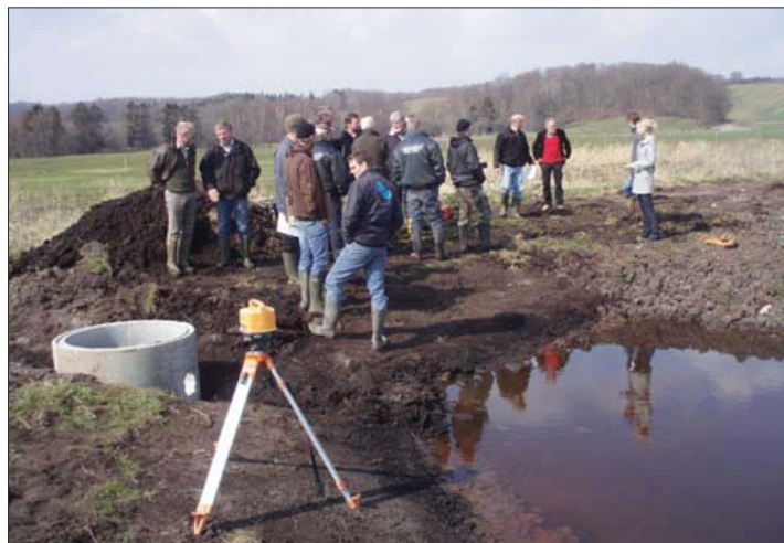
Vandet skal sive fra et indløbsbassin gennem en blanding af sten, ral og halm til en andet vandbassin, hvorfra det ledes ud i et åløb.
